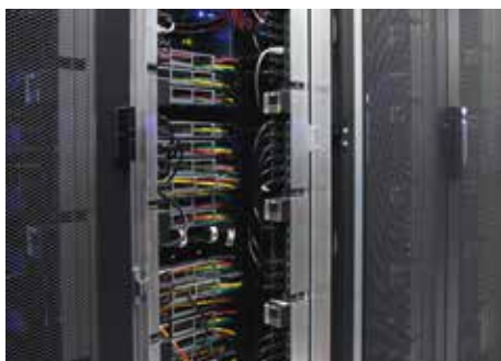
Mit Liebert DCL-Einheit gekühltes Vertiv™ Knürr® DCM Heavy-Duty Rack mit Liebert-Stromverteilungsmodulen und integriertem Kabelmanagement
